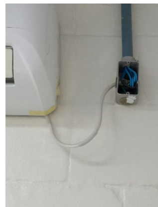
Figura 14: Caixa de fiação elétrica exposta
