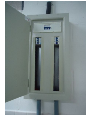
Figura 34: Quadro de disjuntores
