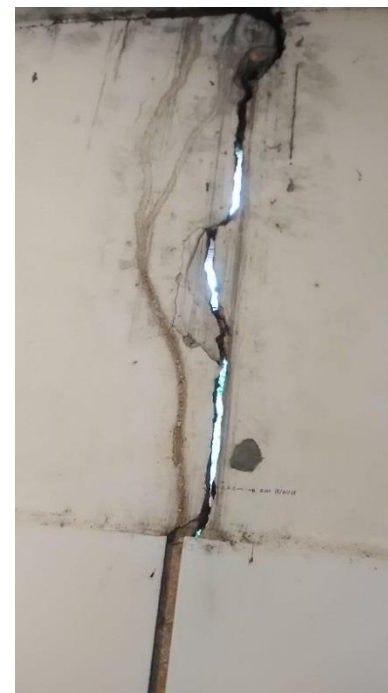
Figura 26: Rachaduras da parede do Laboratório
