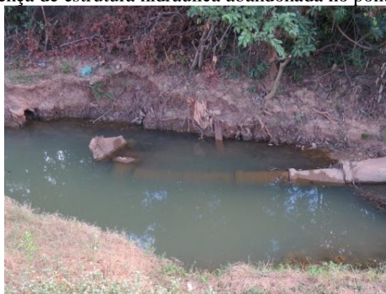
Figura 03 – Presença de estrutura hidráulica abandonada no ponto 05 do Trecho A
