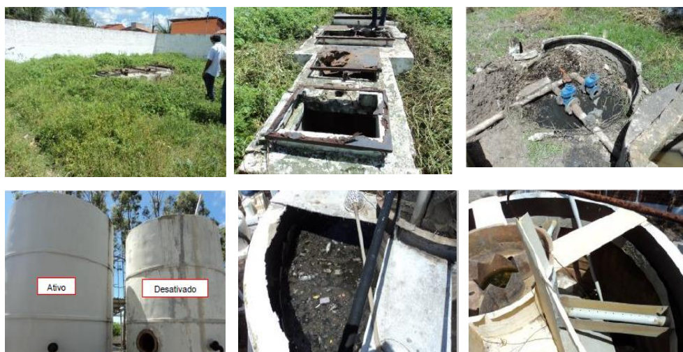
Figura 14. Problemas de manutenção e danos na infraestrutura. Fonte: ARCE (2014).
