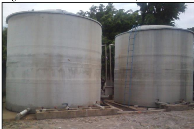
Figura 1 – Vista dos reatores UASB, em escala real.
