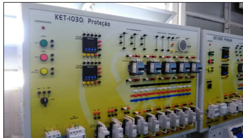
Foto 2: Sala 10 – Bancada de proteção de sistemas elétricos.
