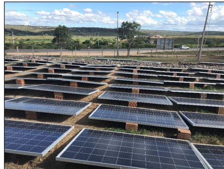
Foto 2: Sala E14 – Painéis solares.
