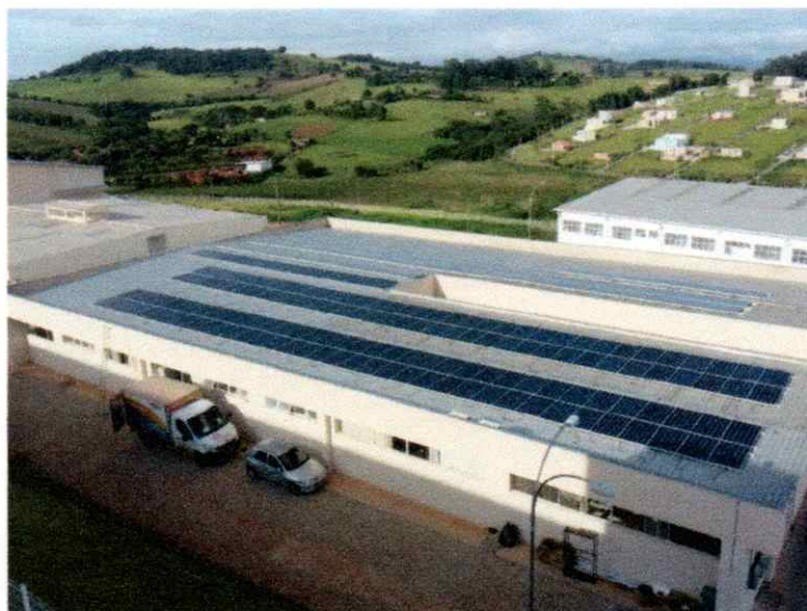
Figura 01 – Células fotovoltaicas no prédio administrativo do IFSULDEMINAS – campus Pouso Alegre
