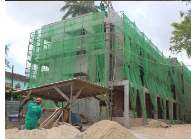
Obra do alojamento masculino (retomada após quase dez anos de interrupção). Fonte: Direção-Geral do Campus Barreiros (2020)
