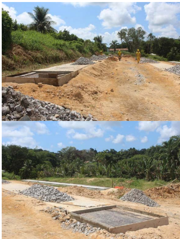
Reforma do Sistema de Esgoto e Tratamento de Efluentes do Campus Barreiros.
