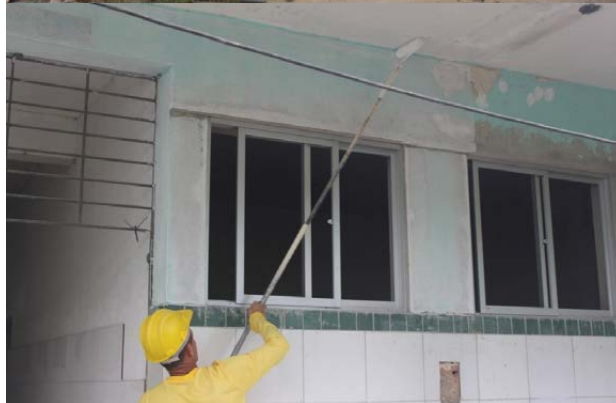
Reforma do prédio do alojamento antigo para receber o bloco pedagógico dos cursos superiores. Fonte: Direção-Geral do Campus Barreiros (2020)
