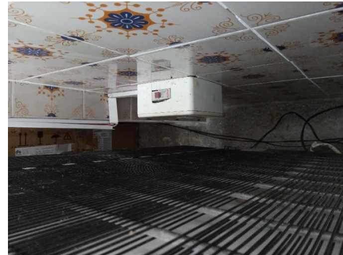
Figura 10: Caixa de disjuntores
