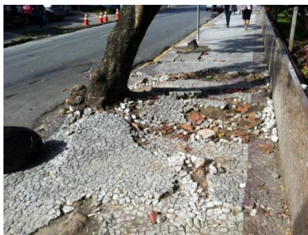
Figura 6 – Calçada do Recife –pavimento levantado Fonte: www.deficienteiciente.com.br
