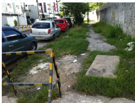
Figura 4 – Calçada do Recife –interrupção do passeio/ Ausência de pavimento. Fonte: http://acertodecontas.blog.br
